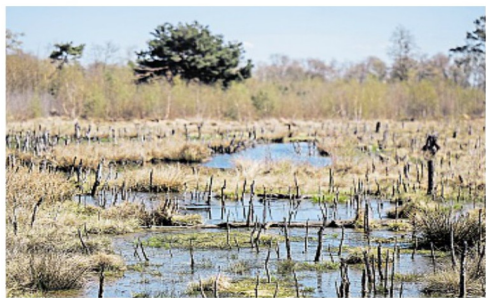
Im ersten Schritt werden im Moor wassersaugende Baumstümpfe von den Flächen entfernt, wenn die Vegetationsperiode zu Ende ist, damit diese wiedervernässt werden. Fotos: Mission to Marsh
